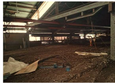
工場内に流れ込んだ土砂 日本パネル工場株式会社 (静岡市葵区津渡野)
